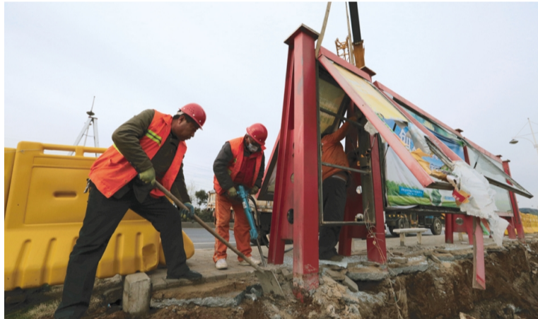
日前，开发区建设局对新光路部分路段进行拓宽改造，华茂盛达市政公司承接了改造路段两侧公交站拆除业务，该公司组织人员加班加点，仅用三天时间顺利完成拆除工作，为后续改造施工节省了时间。图为拆除公交站现场。(张青松 梁作东)
